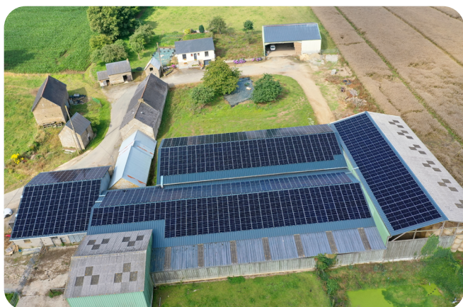
©Objectifs énergies, centrales sur bâtiments agricoles
